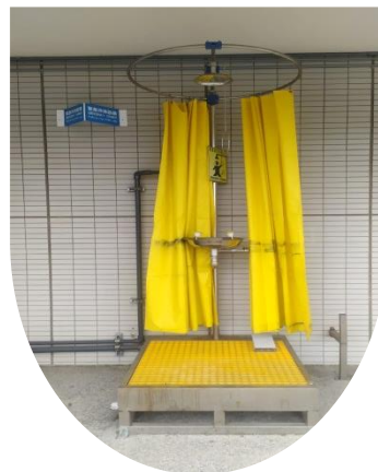
水處理區緊急沖淋設備
